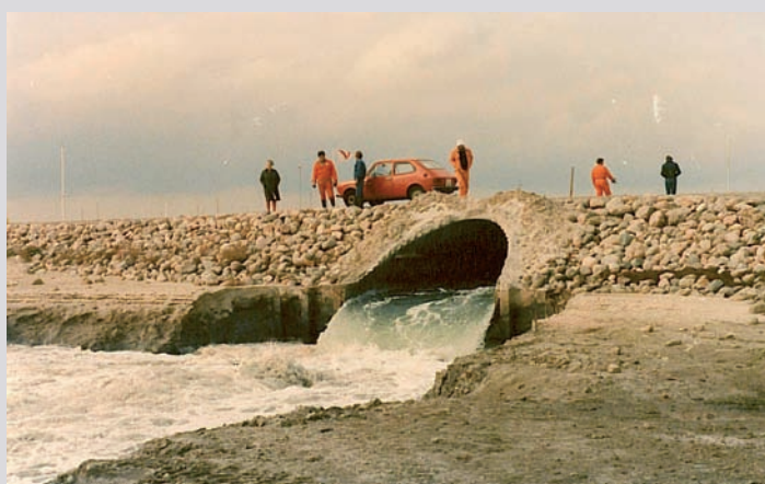
Det dramatiske øjeblik, da vandet bryder gennem røret under vejen til den sydlige havneø.
